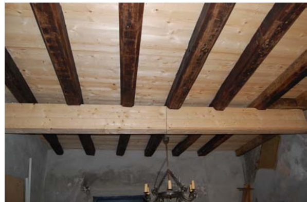
Eiken zolderbalklaag in de heerd, deze vloer wordt met een stalen onderslag ondersteund.
