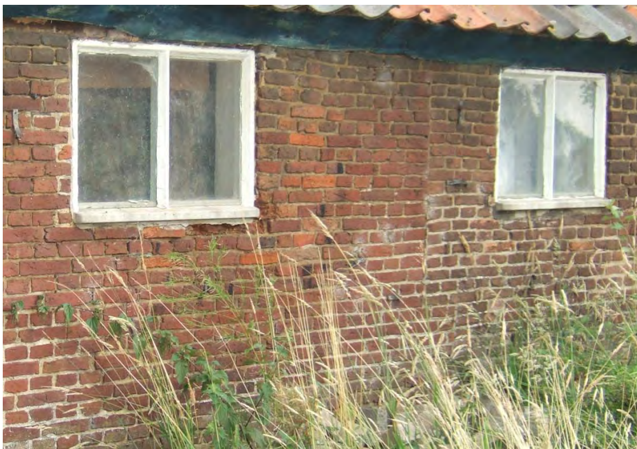
Detail van de linker zijgevel. Duidelijk zichtbaar is de bouwnaad in het metselwerk.
