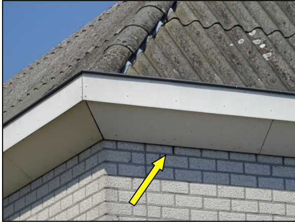
Figuur 10. Open stootvoeg aan het hogere deel van de sportzaal.
