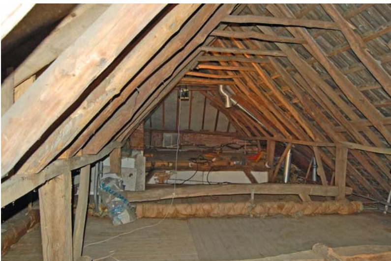
Overzicht van de gebintenstructuur op zolder in de richting van de voorgevel.
