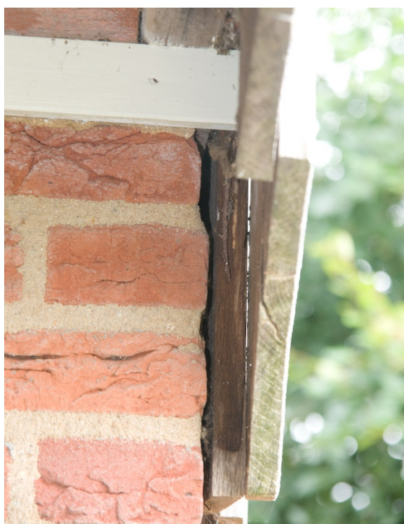
Houten betimmering die ruimte biedt voor de aanwezigheid van vaste rust- en/of verblijfplaatsen van vlemuizen.
