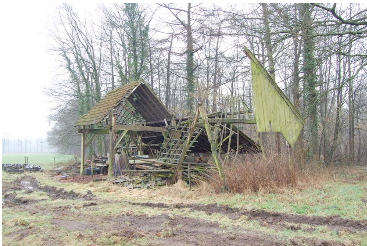
Overzicht van de gedeeltelijk ingestorte veldschuur, die tegen de bosrand aan de zuid-oostzijde van het erf gesitueerd is.
