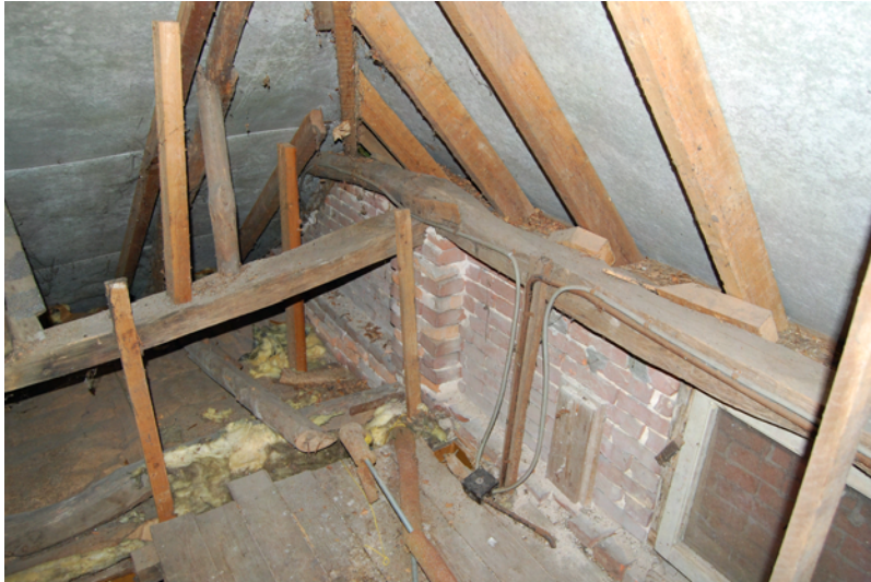
Binnenzijde van de voorgevel uit 1912, die met dezelfde bakstenen als de huidige achtergevel is opgetrokken.
