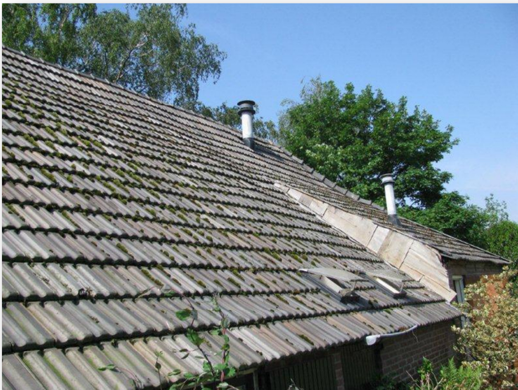
Zicht op de oostzijde van de kap van de boerderij (met eenzijdig sleepdak)
