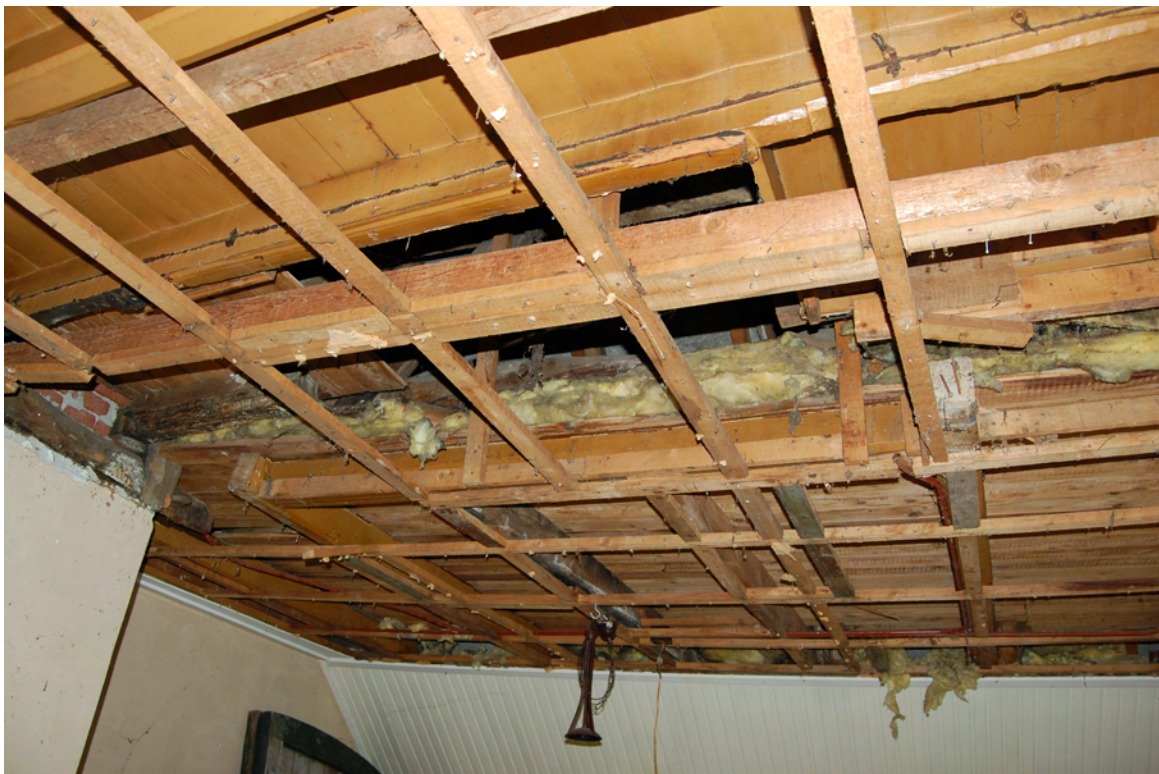
Enkelvoudige balklaag van het woongedeelte met daarin de forse raveling van de verdwenen schouw.
