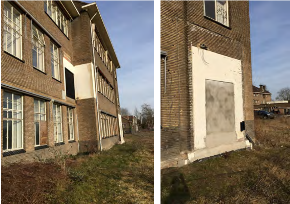
Figuur 4.24 en 4.25 bestaande beschadiging. De oude verbingsgang is hier gesloopt.
