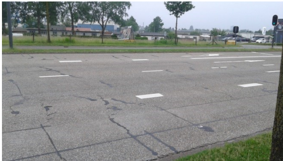
Foto 1: scheuren in opstelvak Holterweg
