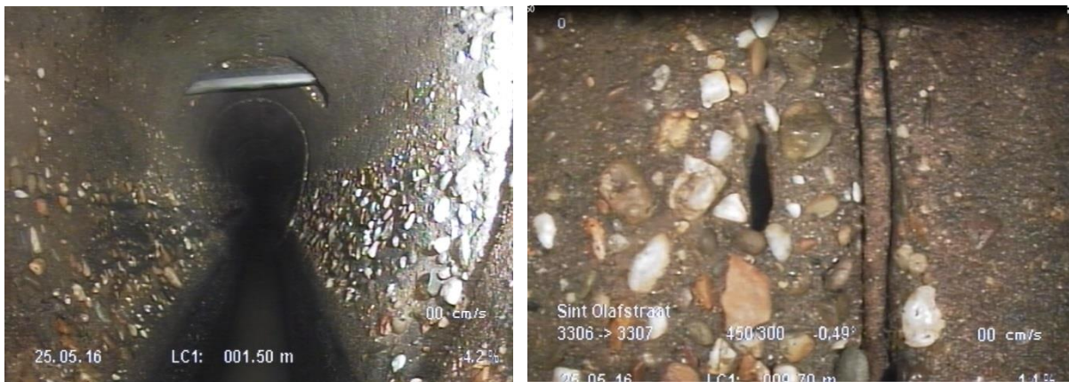
Riool Olafstraat – betonaantasting en holle ruimtes
