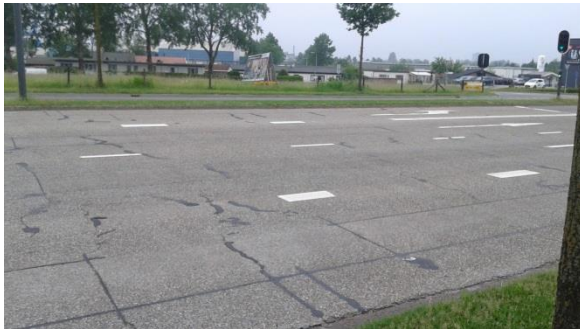
Foto 1: scheuren in opstelvak Holterweg
