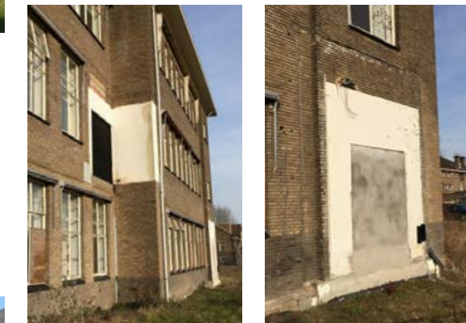
Bestaande beschadiging na sloop van verbindingsgang naar het na-oorlogse ziekenhuisgedeelte
