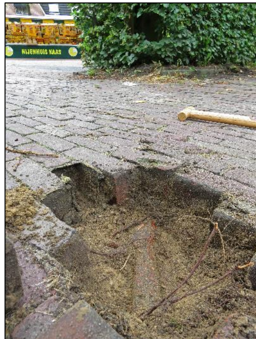
Figuur 12 Oppervlakkige wortels onder het voetpad
