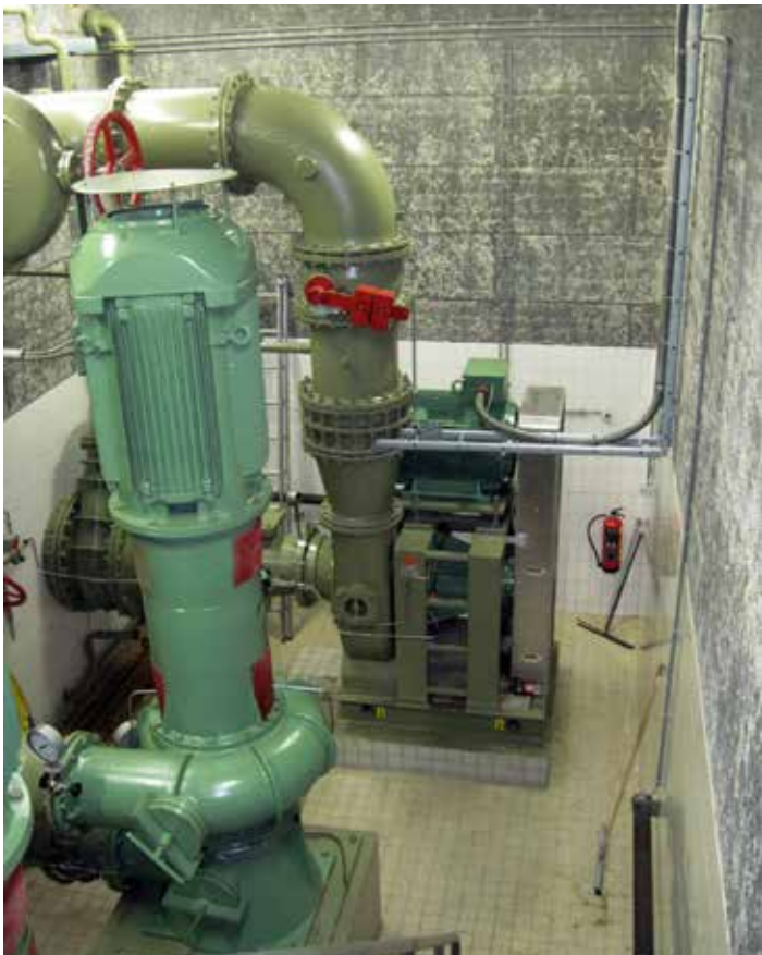
Rioolgemaal Groot Colmschate
