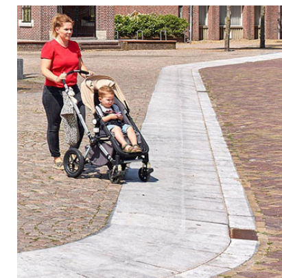
Pleinrand Grote Kerkhof, special Natuursteen, Belgisch hardsteen, Leverancier: Carrieres du hainaut afwerking gefrijnd, frijnrichting haaks op de band (licht grijs) 2x band van natuursteen, 80cm breed, zie detailuitwerking band
