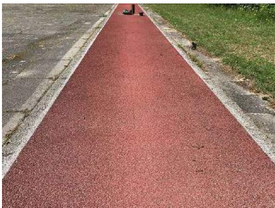
afb. 3: lijnen staan gedeeltelijk op de opsluitbanden
