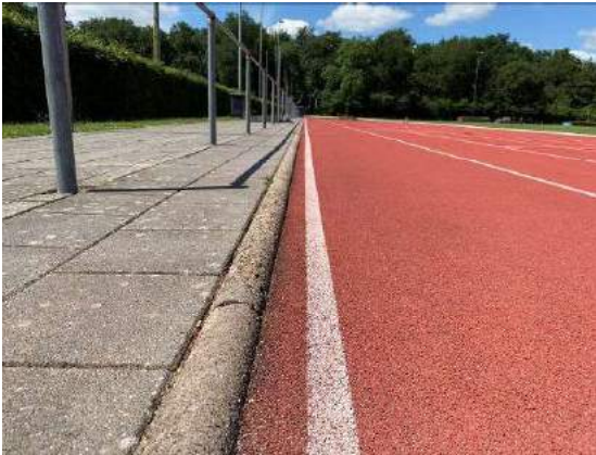
afb. 1: verhoogde afgeronde opsluitband / afstand hekwerk voldoet niet,
