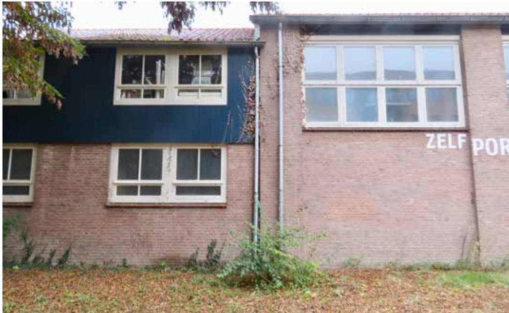
Afb. 33 - Ophoging uit 1978 op de kleedkamers, in de aansluiting aan de gymzaal (rechts).
