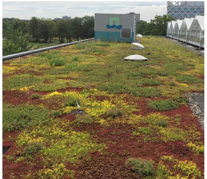
Water bufferen op retentiedaken
