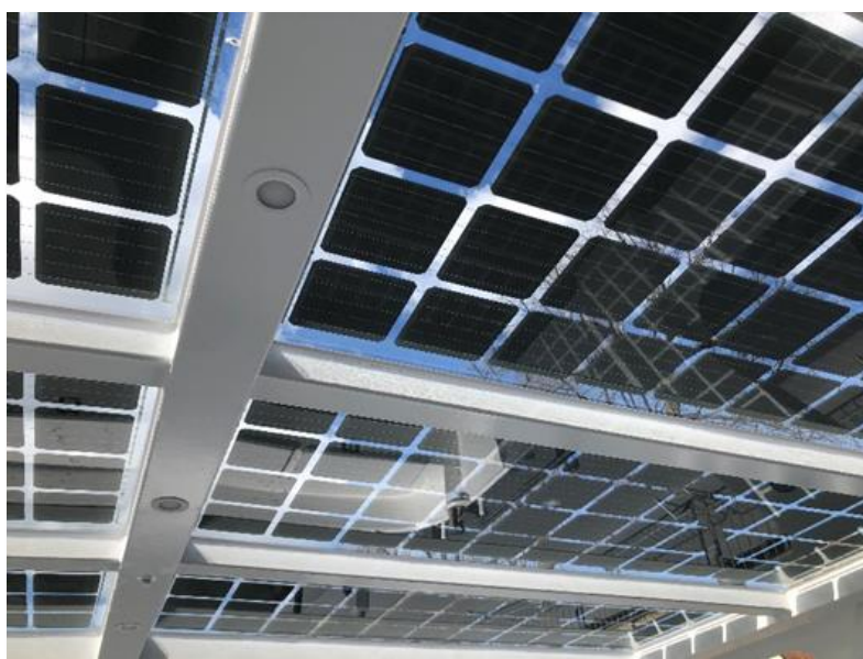
Figuur 1: zonnepanelen op het voetveer over de IJssel
