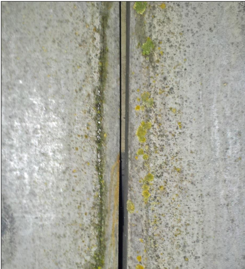
Figuur 5-6. Eén van de verticale stootvoegen tussen de betonnen bouwelementen van het ecoduct over de A1. Deze spleetvormige ruimtes zouden kunnen functioneren als paarverblijfplaats voor gewone dwergvleermuis (Pipistrellus pipistrellus). Foto: R.M. Koelman.
