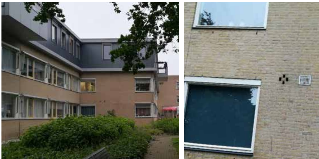
Het appartementencomplex met open stootvoegen en andere openingen naar de spouw.
