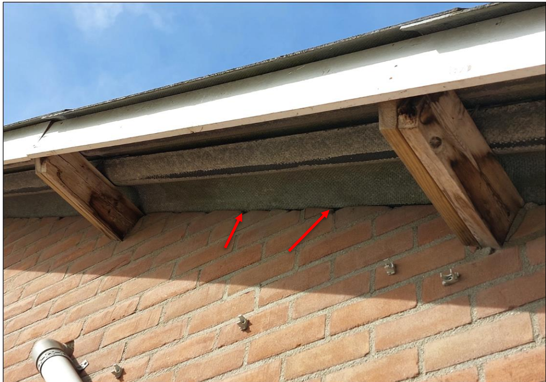
Figuur 4.1 Openingen in de varkensstal tussen dakplaten en buitenmuur aangeven met rode pijlen (Foto: Ecogroen).
