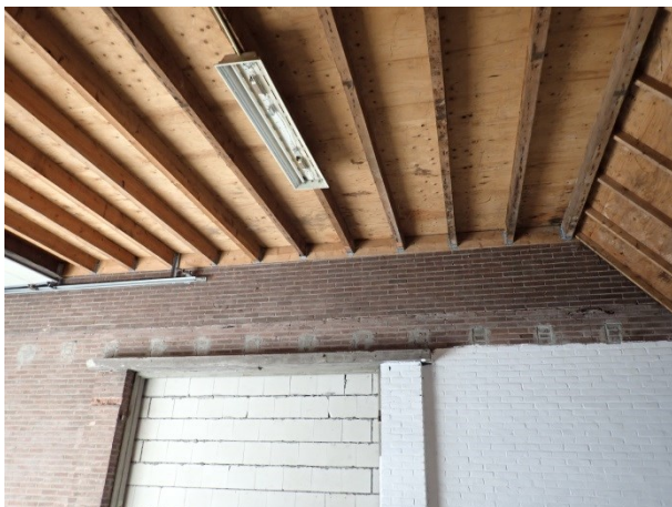
Foto 6: dakbeschot in de richting van de zuidmuur. Hier is een oorspronkelijke deur dichtgezet bij de bouw van een nevenstaande loods.
