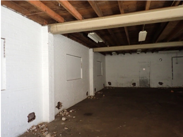
Foto 4: de loods aan de binnenzijde. Door de aanwezigheid van de gaten kon de spouw goed worden onderzocht.
