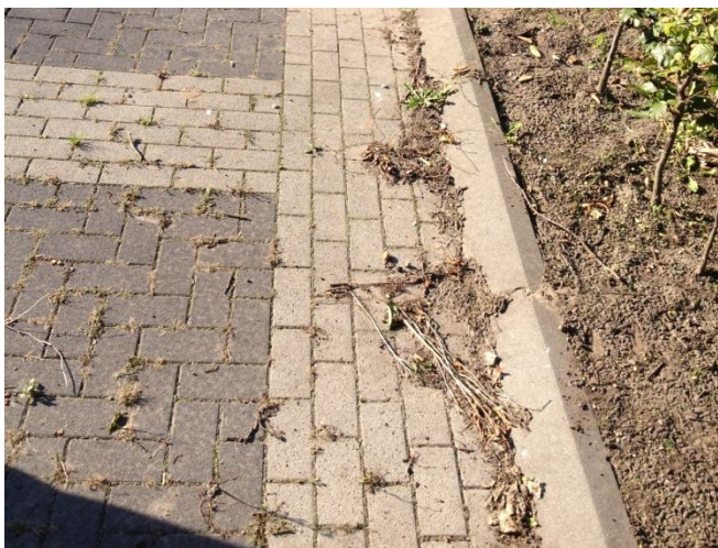
Figuur 6: Vervuiling van de verharding door groenstroken
