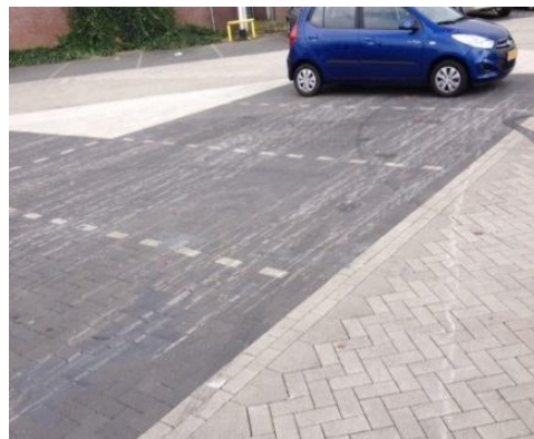
Figuur 10: Schade op evenemententerreinen
