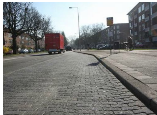
Figuur 14: Spoorvorming in de busroute
