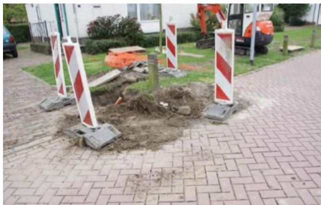
Figuur 8: Vervuiling van de verharding door graafwerkzaamheden
