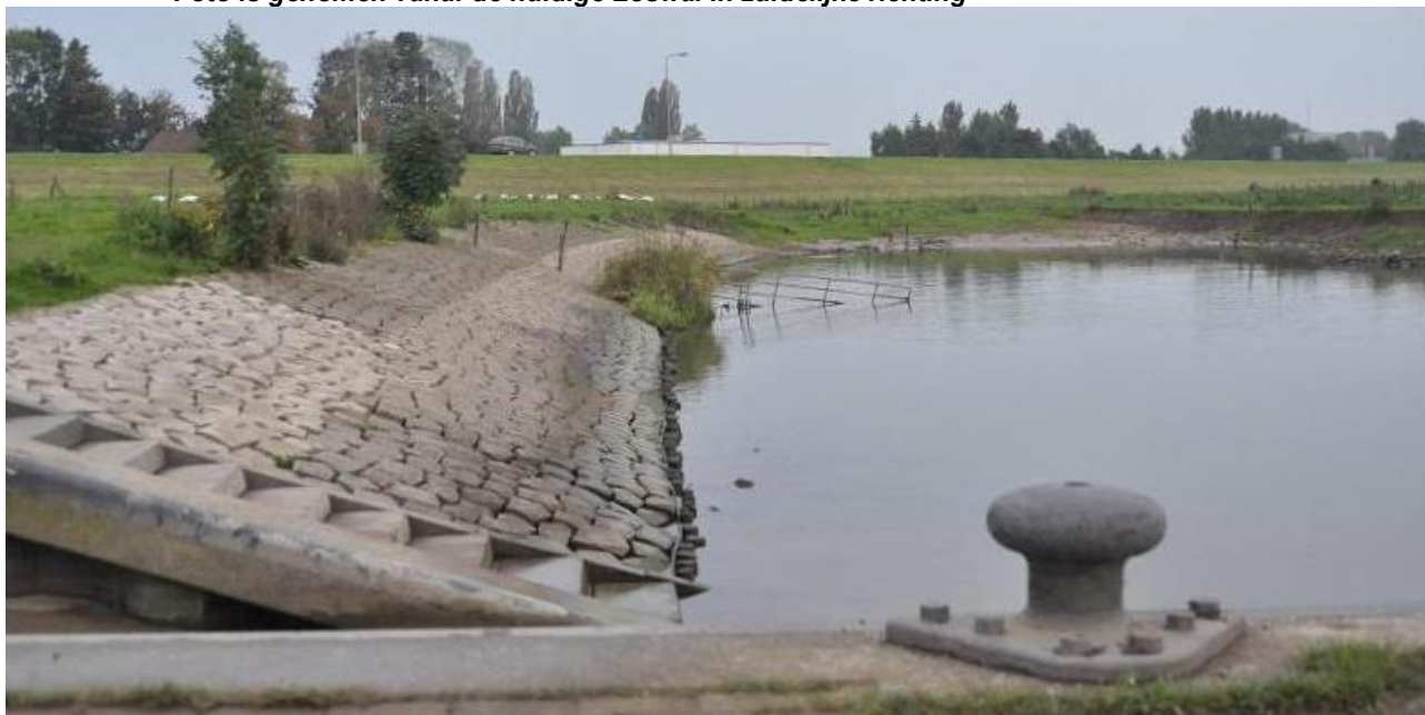
Figuur 5.1 Huidige situatie met zetsteenbekleding ten zuiden van de botenhelling (linksonder). Foto is genomen vanaf de huidige Loswal in zuidelijke richting
