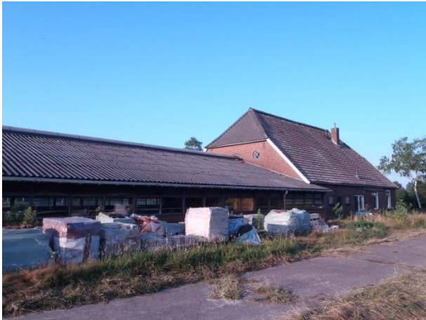
Foto 1: stal met woonhuis gezien uit westelijke richting. Op het woonhuis zijn de panlatten zichtbaar. Aan deze zijde zijn alle pannen verwijderd.
