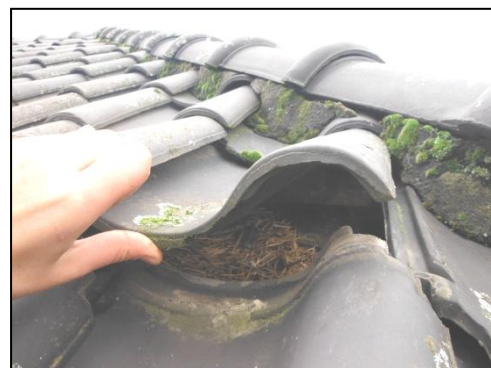
Figuur 10. Aangetroffen nestrest onder dakpan sportzaal.
