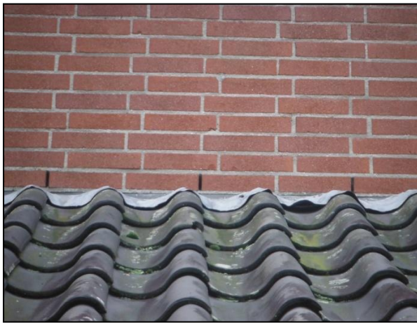
Figuur 11. Openingen in spouwmuur.
