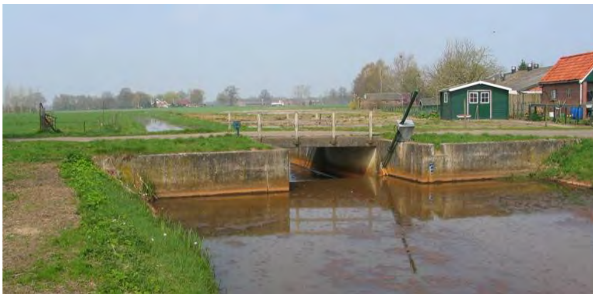
Veengoot met brug en stuw bij Harreveld; waarschijnlijk gebouwd bij de verbetering van de Veengoot in 1926-1927
