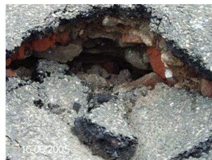
Instorting weg door gebroken riolering (Groenlo)
