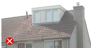
te hoog op het dak, profiel van de woning wordt aangetast
