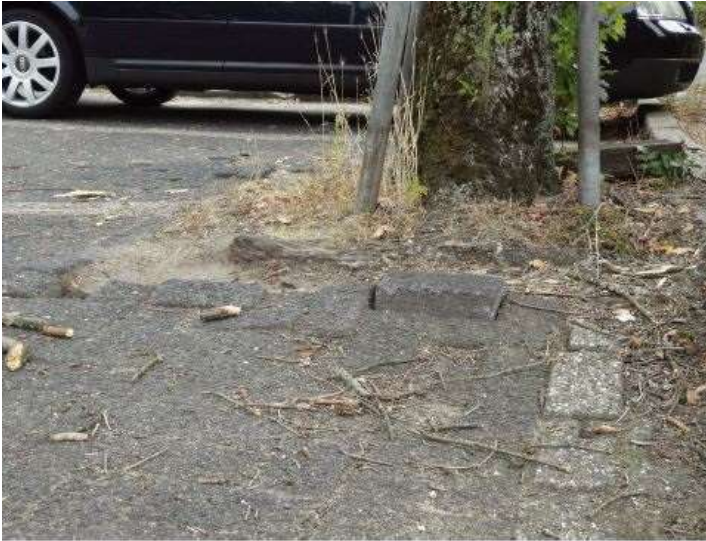
Bomen zonder ruimte veroorzaken schade en overlast (Bleekwal Lichtenvoorde)
