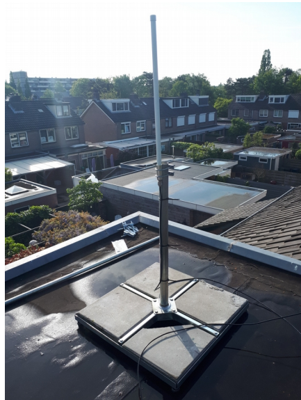
LoRaWAN antenne op een dakkapel in Zeist-noord
